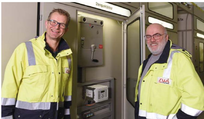
v.l.: Thomas Kettler (ehemals EGH) und Udo Hackmann (SWL) trafen sich zur offiziellen Übergabe des technischen Netzbetriebs Anfang Januar in einer Umspannanlage der SWL.
